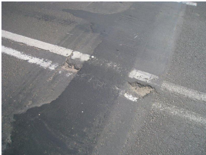
Fot. 8 Zły stan techniczny drogi
