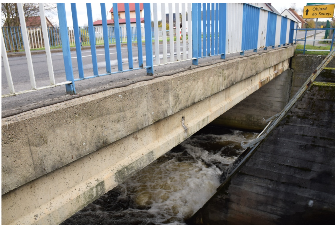
Zdjęcie nr 4 – Widok na belki prefabrykowane od strony południowej. Źródło: - na podstawie wizji lokalnej
